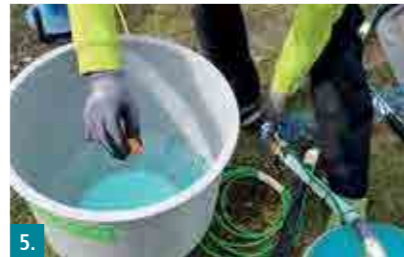
5. Beim Spülen mehrmals Schwammkugeln verwenden.
