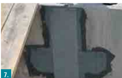
7. Auf der durchgetrockneten Kratzspachtelung Botament® RD 1 | RD 2 auftragen. Botament® GS 98 Glasseidengeewebe in die erste Abdichtungslage einbetten. Fugen mindestens 15 cm auf beiden Seiten überlappen.
