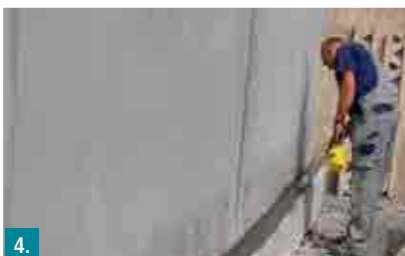
4. Mörtelhohlkehle aus Botament® M 36 Speed einbauen. Alternativ Innenecke mit Botament® SB 78 Systemdichtband und RD 2 ausführen.
